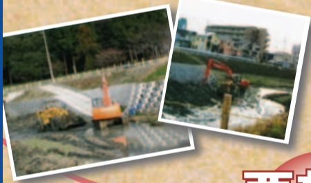
県住宅市街地基礎整備事業で 葉山川・中ノ井川(放水路) 河川改修進む(治田西)
